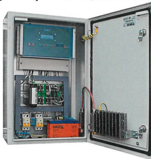
Рисунок А.7.17 – Устройство запуска и контроля сирен оповещения в шкафу запуска и контроля сирен оповещения
