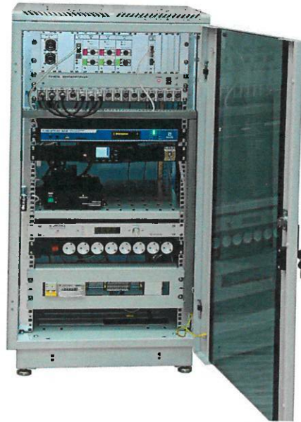
Рисунок А.4.9 – Комплекс громкоговорящего оповещения ИТК ОС КГО (на базе МКУ «РОКОТ»)
